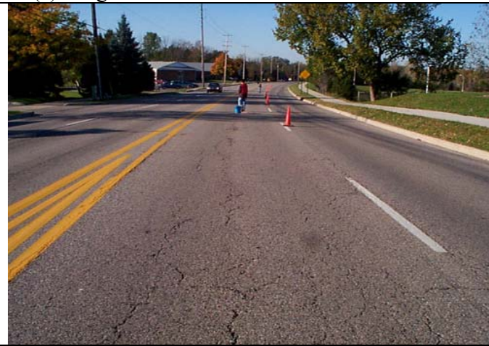
(d) Extensive TDC in Marsh Road
