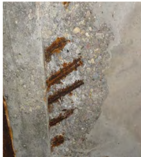
(d) Corroded reinforcement (tail span, WB)
