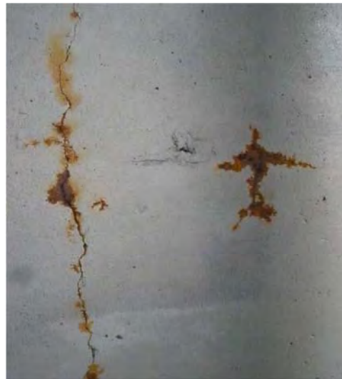
(d) Longitudinal bottom cracks and corrosion traces (Scale \approx 1:20 ) (tail span)
