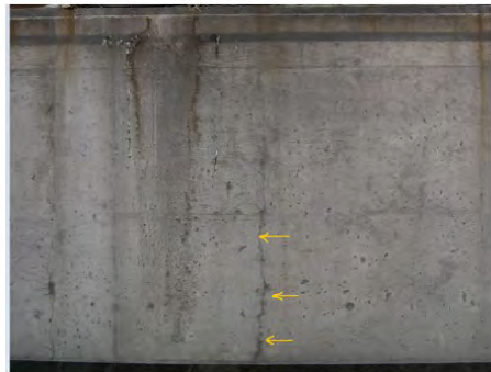
(d) Flexural cracking
