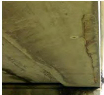
(b) Bottom flange longitudinal cracking
