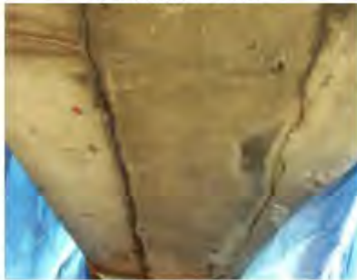
(d) Wide longitudinal cracking (Cracking-PSC 1110) Condition State 4
