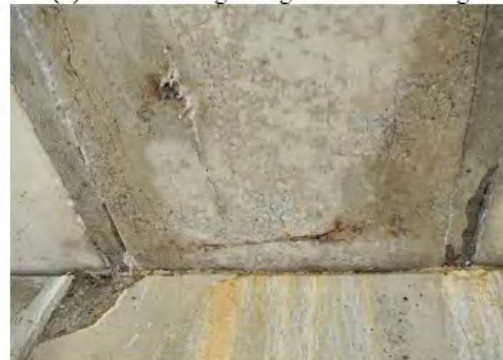
(d) Bottom flange random cracking
