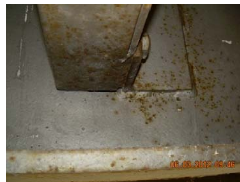
(d) Close-up view of the web gap
