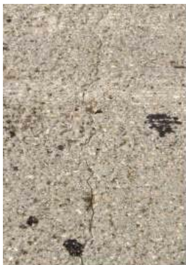
a. Longitudinal Crack
