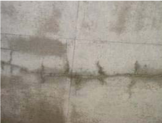
a. Longitudinal crack
