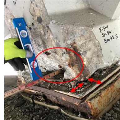
(d) Severe spall
